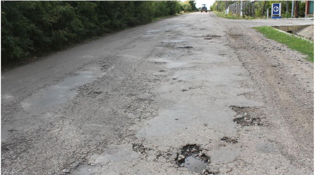
Рис. 2.3 Ділянка дороги Снятин-Тязів до ремонту
